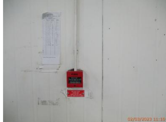
20. Fire alarm button.jpg
