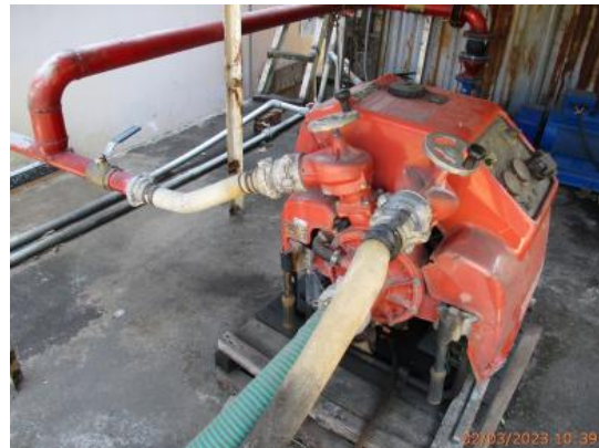
26. Fire pump area.jpg
