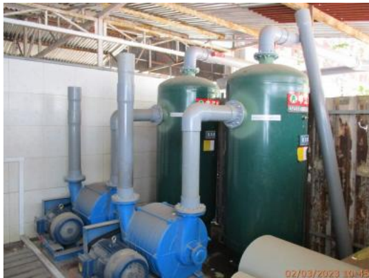
45. Air compressor area.jpg
